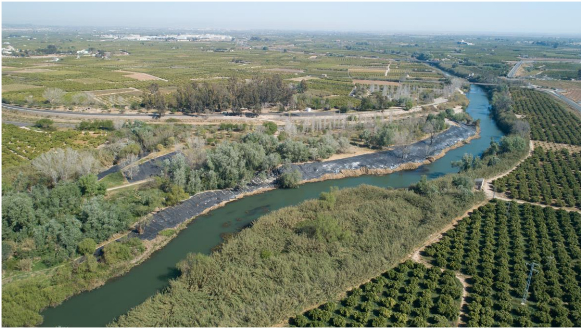
Coberturas opacas instaladas en la chopera de Algemés previo desbroce del cañaveral. Fotografía: Fernando Ramia (1-04-2019).
