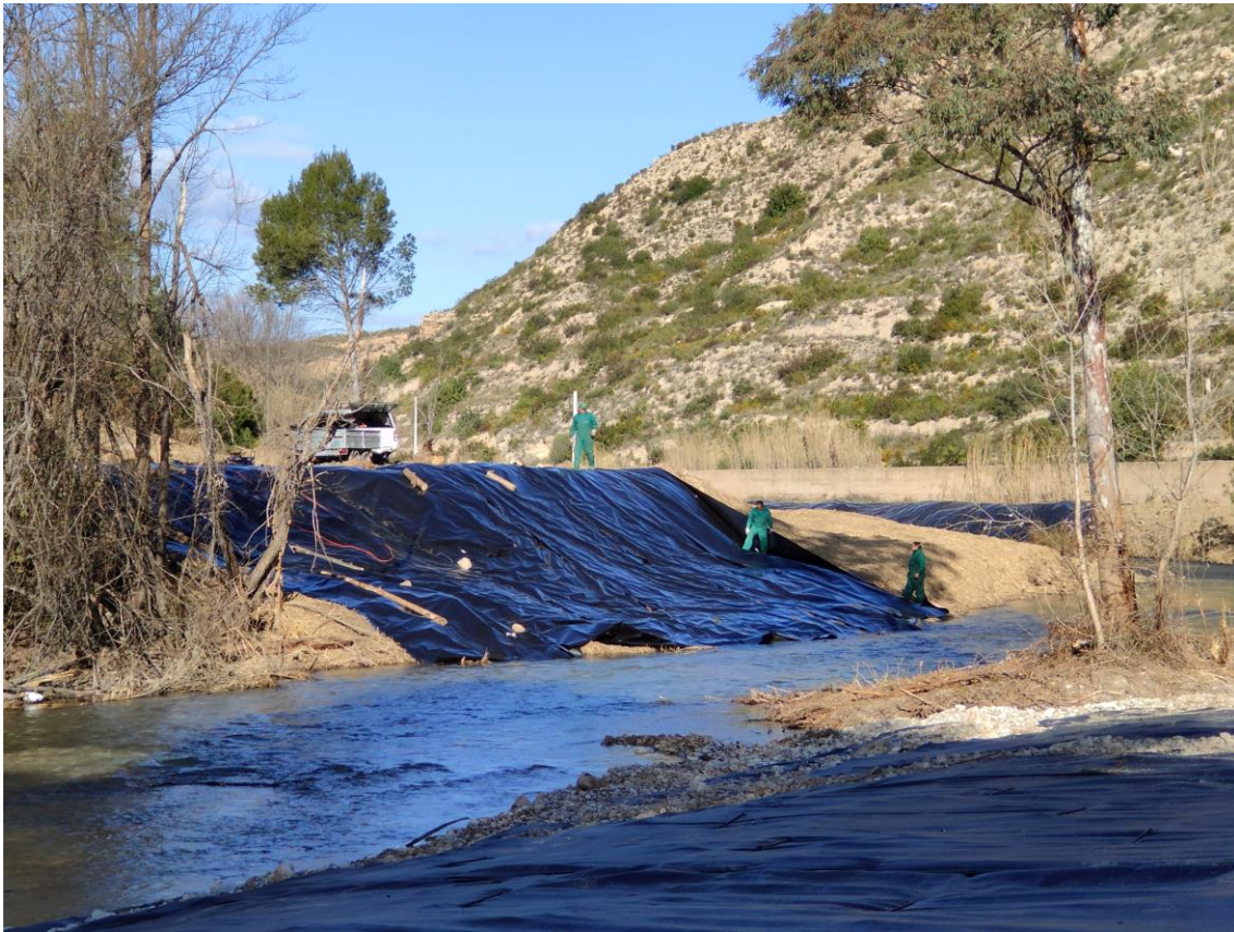
Colocación de cobertura opaca en el río Turia junto al balneario de Chulilla. Fotografía: Ramón G. Pereira (17-01-2020).
