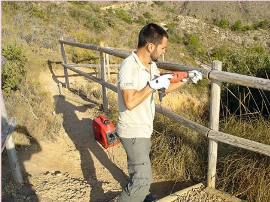
Fotografía: Reparación de un tramo de valla en un mirador del camí del Far (l'Alfàs) Fuente: Archivo fotográfico del Parc Natural de la Serra Gelada
