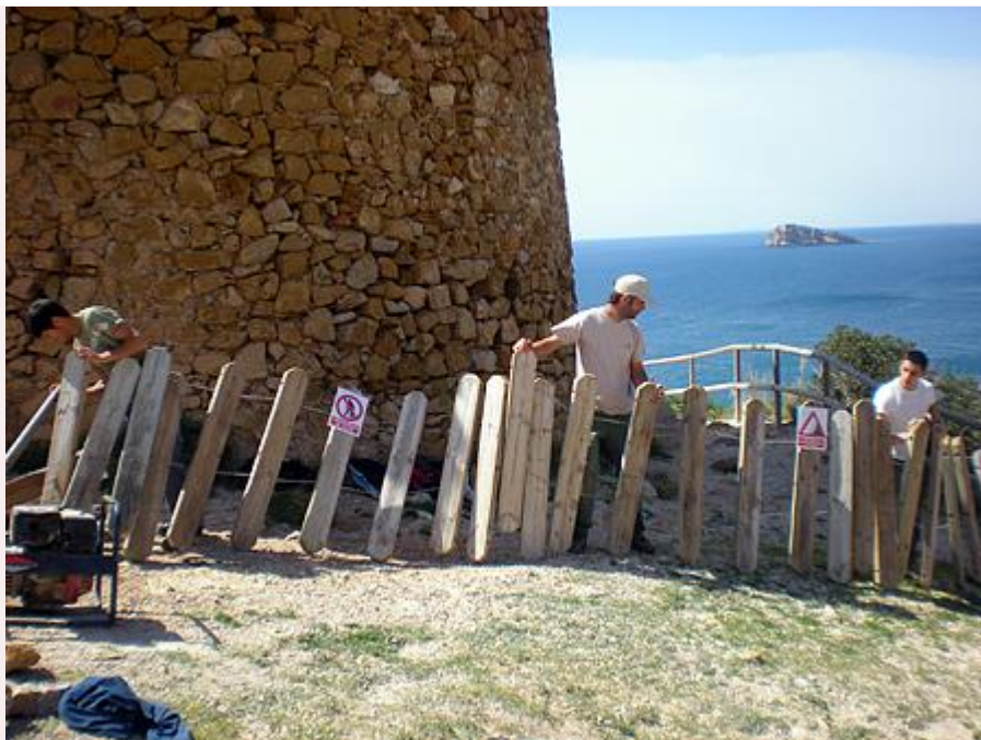
Fotografía: Colocación de cerramiento temporal facilitado por el ayuntamiento de Benidorm en la torre de Seguro (Punta Cavall) por desprendimiento de rocas desde la misma torre
