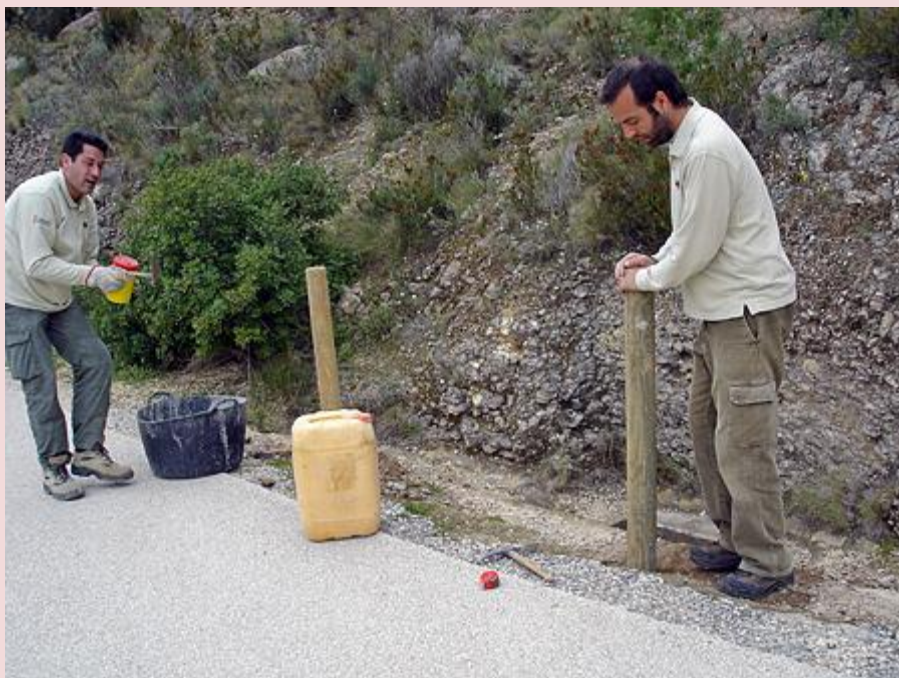
Fotografía: Colocación de pequeñas barandillas de seguridad en los desagües de pluviales de la Ruta Roja (L'Alfàs)
