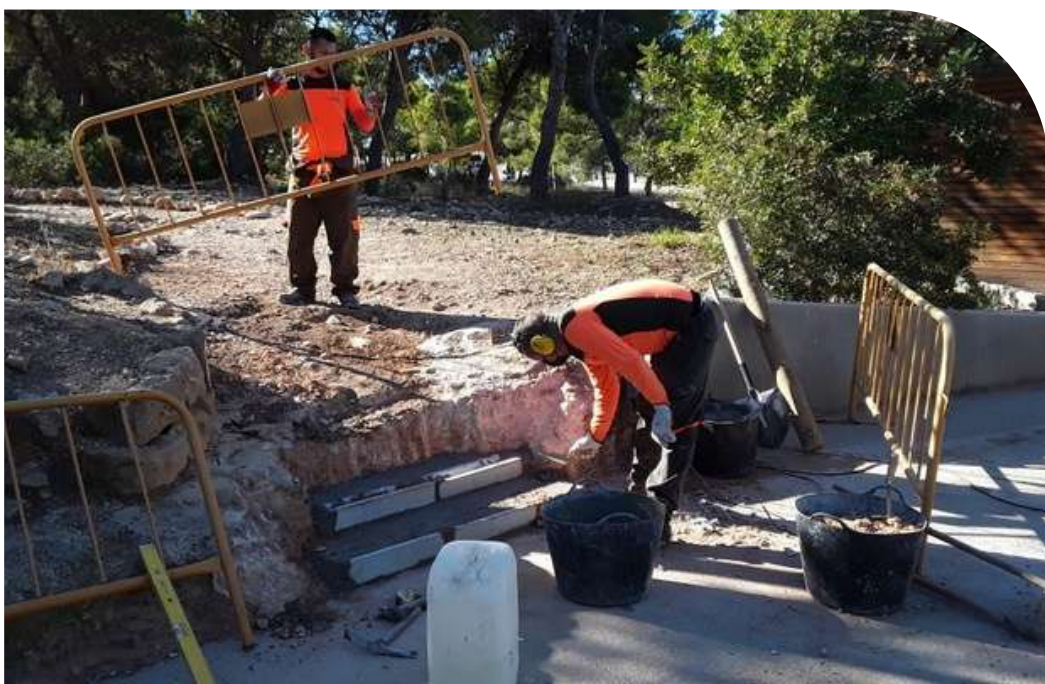
Imagen: Trabajos de mejora del acceso a la ruta amarilla desde la ruta roja - PN de la Serra Gelada.
