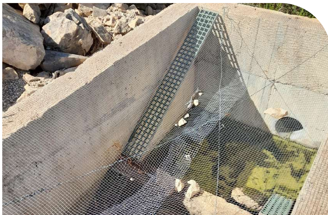
Imagen de los distintos elementos colocados para evitar la caída accidental de fauna en el sistema de captación del agua del depósito de extinción de incendios de l'Alt del Governador.
