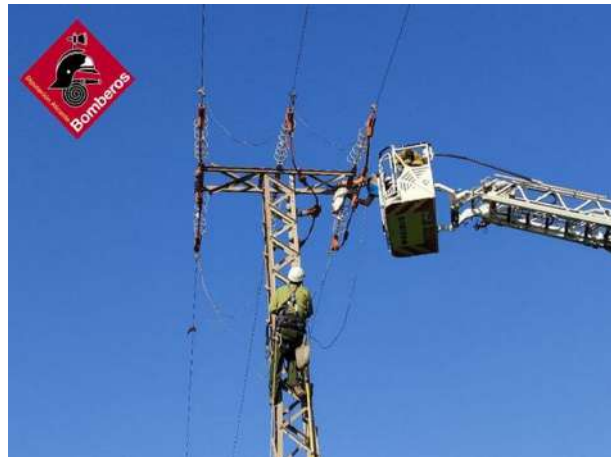
Figura 6.2-3: Rescat d'Estell atrapat en una torre elèctrica. Font: Consorcio Bomberos Alicante.
