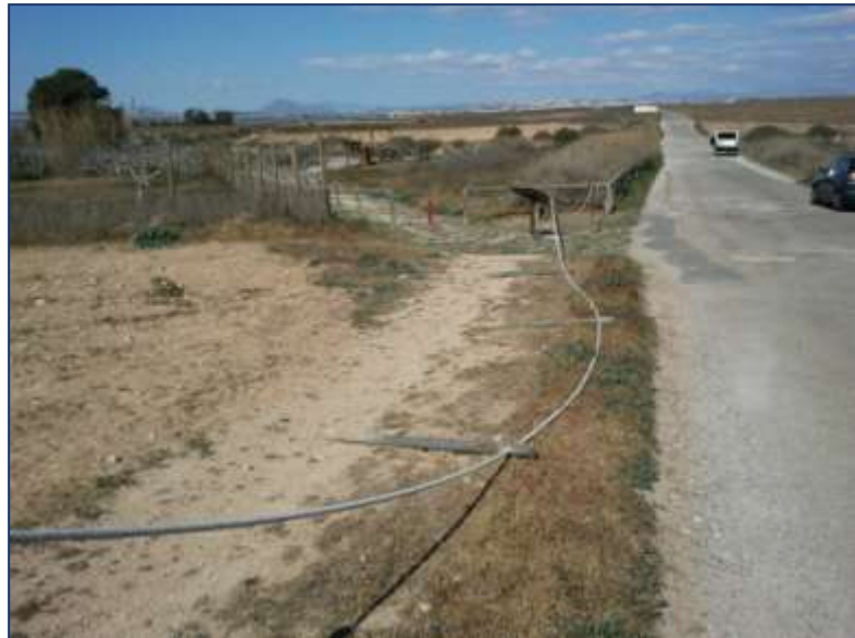
ILUSTRACIÓN 63 ROTURA DE VALLADO POR VANDALISMO
