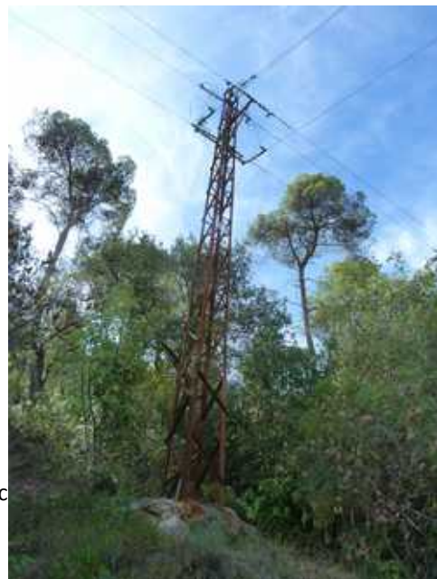
Detall del punt d'entroncament de la línia elèctrica al barranc de l'Infern
