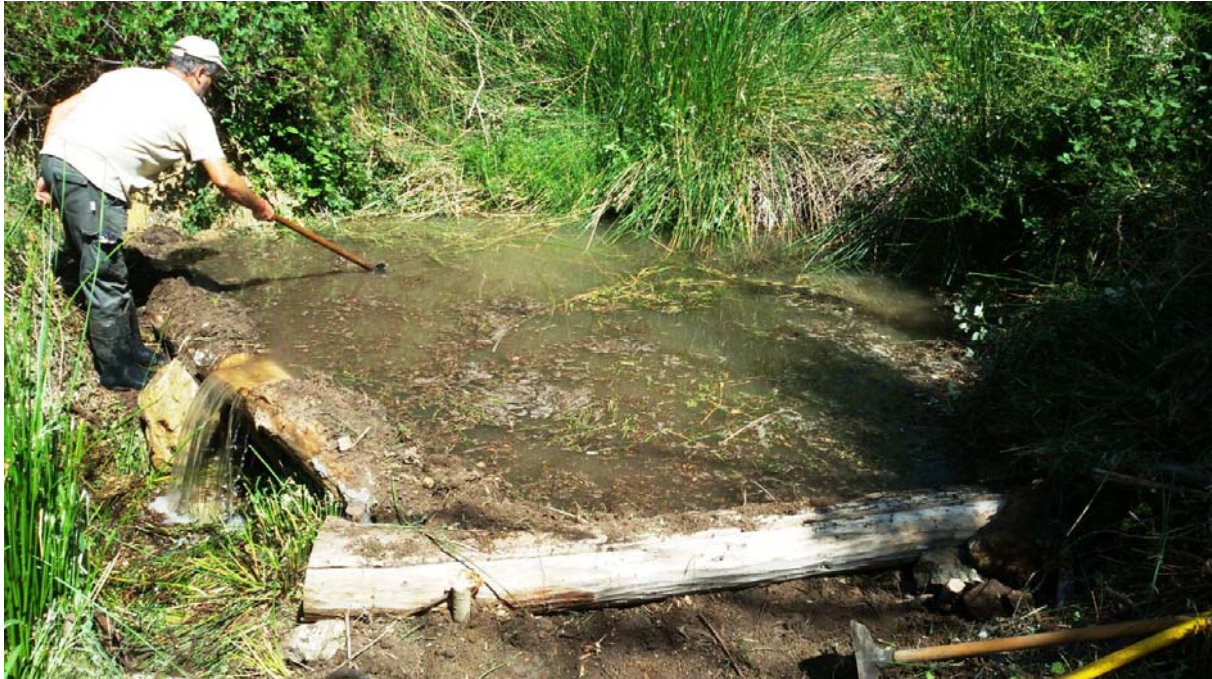
Fig.6. Trabajos de acondicionamiento del barranco de la Fuente Gorda, a cargo de la Brigada del Parque Natural de Chera / Sot de Chera, realizado en 2017.
