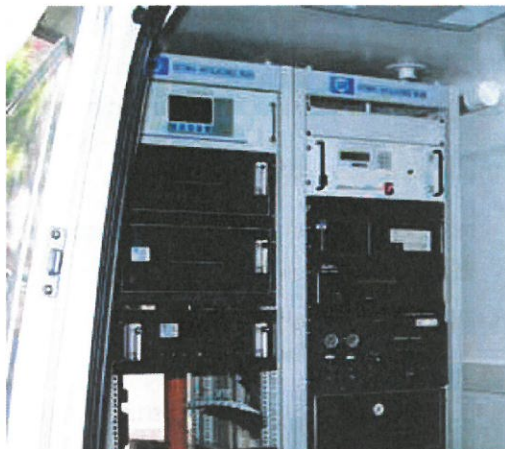
Vista interior de una estación móvil.
