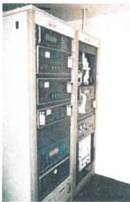
Armario de instrumentación de una estación de medida de contaminantes.
